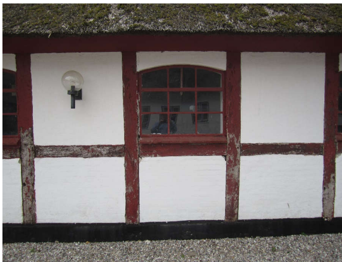
Fag 4-6 fra vest. Sprækker ved tømmer mellem stolpe og løsholt.
