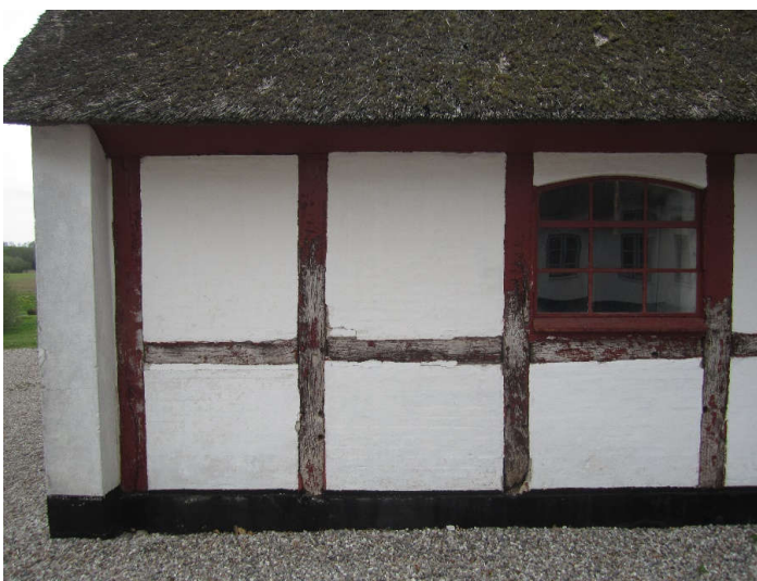
Fag 1-3 fra vest. De malede overflader på bindingsværkstømmeret er nedvasket på facadens nederste halvdel.
