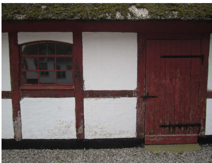
Fag 7-9 fra vest. Sprækker ved tømmer mellem stolpe og løsholt. Revledørens brædder er rådskadet.
