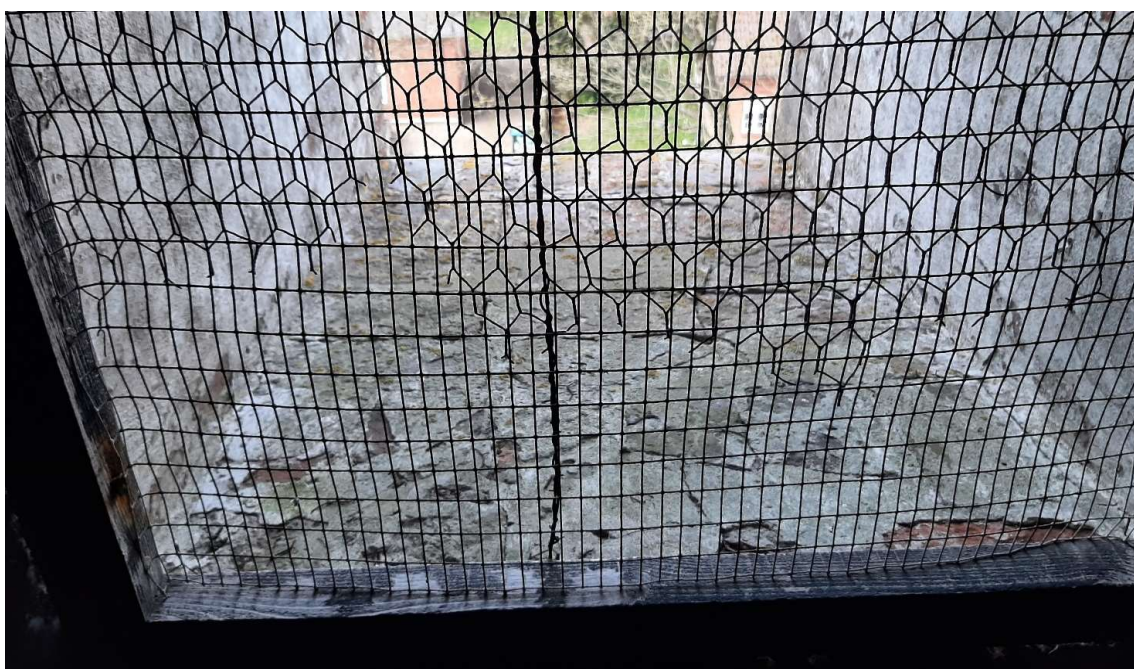
"Sålbænken" ved klokkelugen. Her skal fuger m.m. være intakte for at forhindre for meget vand i muren.
