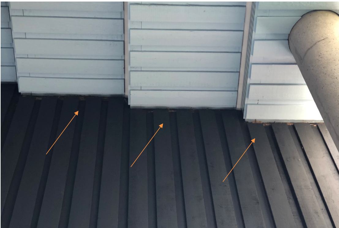
Ydervæg og loft mod nord. Bemærk svampe frugtlegemer ved pile. Forekomsten er umiddelbart kraftigst ved søjlen og dermed betonflanchen til ydervæggen. Dette tyder på kondens.
