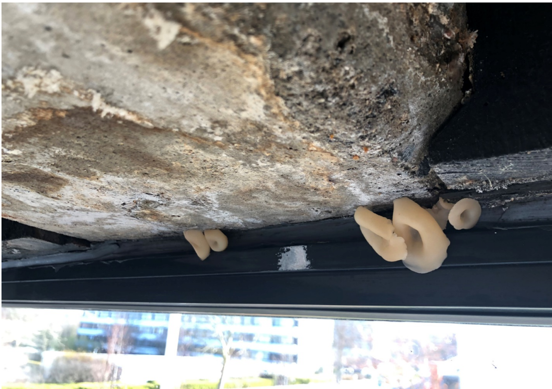
Synlige frugtlegerer under betonflanche.
