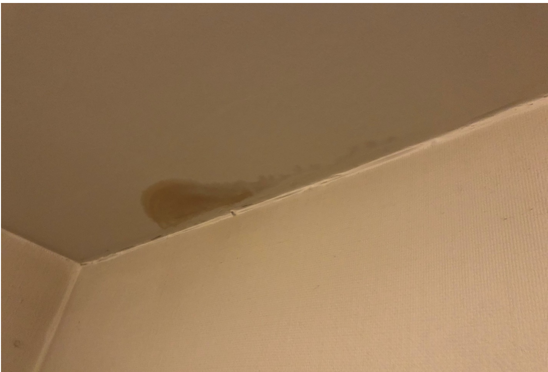
Fugtskjold under ventilationsinddækningen.
