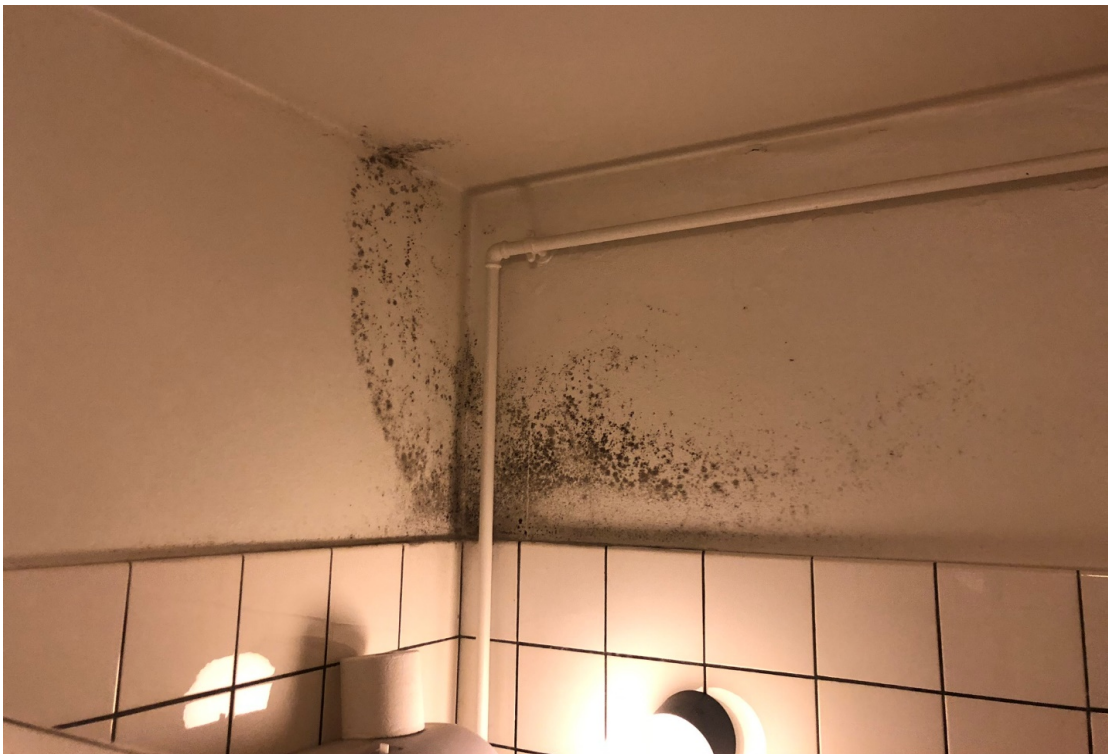
Foto af ovenstående hjørne. Det er tydeligt, at skimmel opstår hvor der er en kuldebro.
