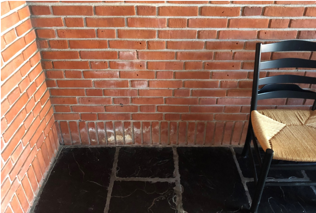
Fugtskjold i våbenhuset over skaden i kælderlokalet.
