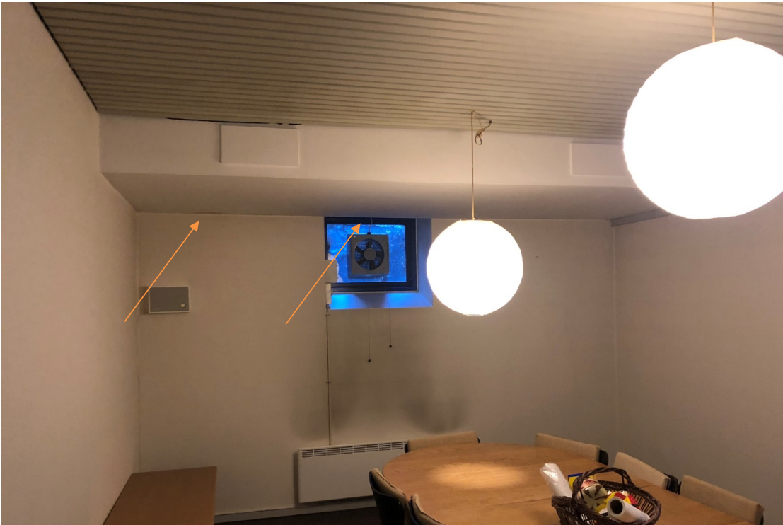
Kælderlokale. Pile markerer fugtskjolder. Bemærk, de lukkede ventilationsriste.
