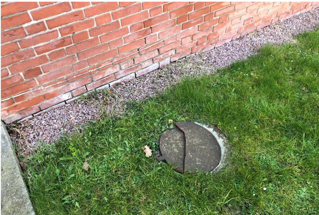
Ødelagte fuger over fugtskjoldet i kælderen. Inde i væggen er de skjulte nedløb. Et tilsvarende findes mod nord. Bemærk, at brønddækslet skal skiftes.
