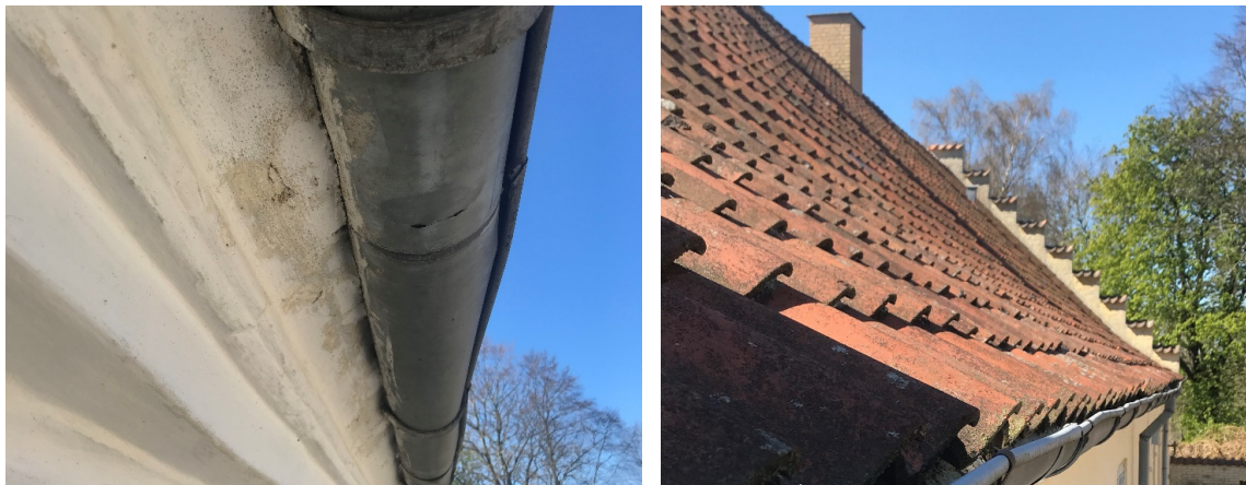
Fig 12 Detalje hovedgesims med brud i tagrende og foto tagflade med teglafdækkede kamtakker
