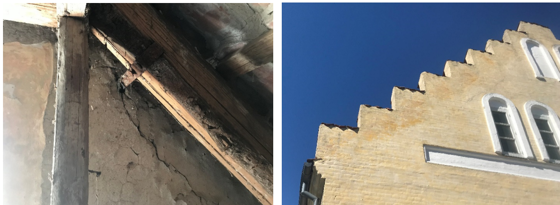
Fig 7. Eksempler på revnedannelser og tryksskader i de murede overgavle, vestgavl og østgavl
