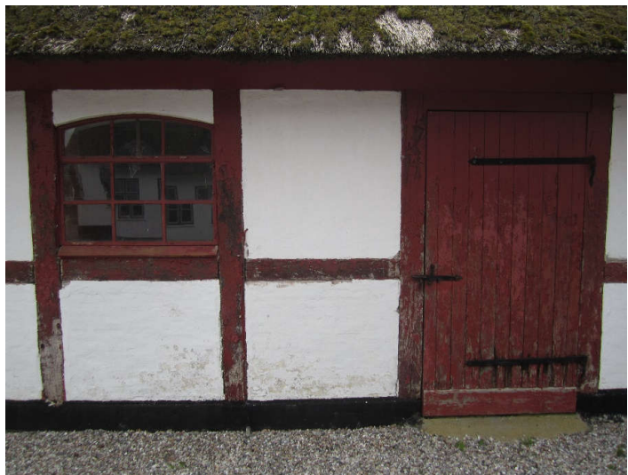
Fag 7-9 fra vest. Sprækker ved tømmer mellem stolpe og løsholt. Revledørens brædder er rådskadet.
