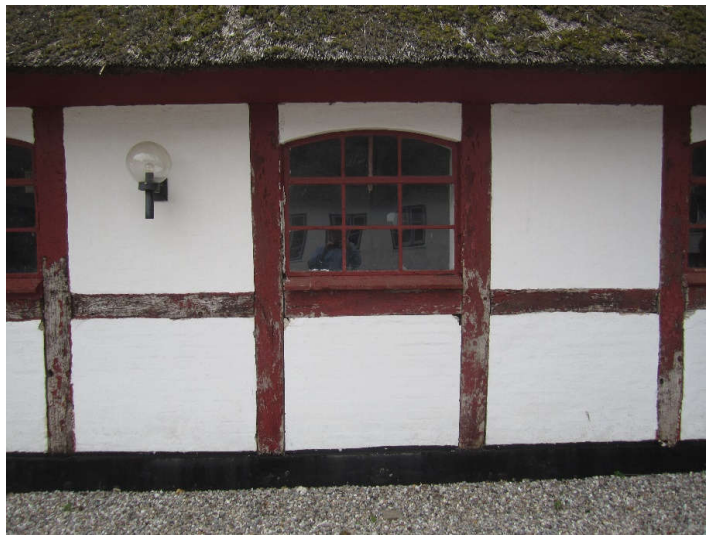
Fag 4-6 fra vest. Sprækker ved tømmer mellem stolpe og løsholt.
