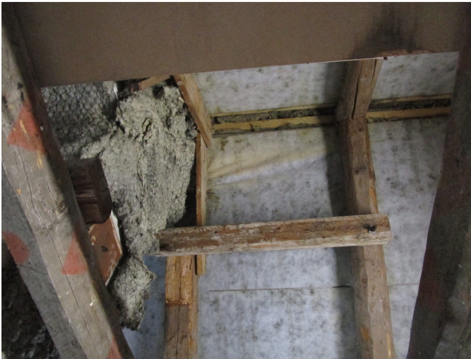
Kippen er udfyldt med mineraluld og der er ingen ventilation
