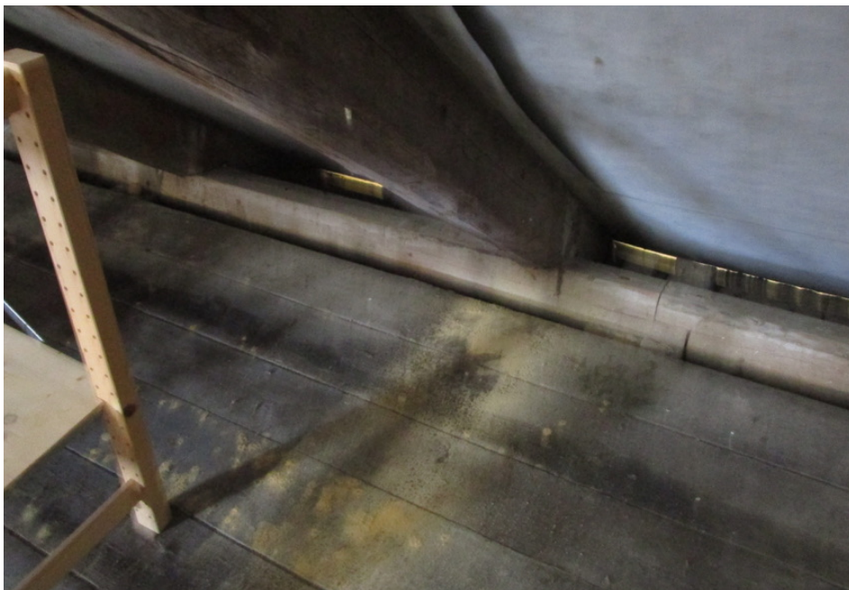
Boremel fra borebiller i gulvet og ringe ventilationsspalte i tagfoden
