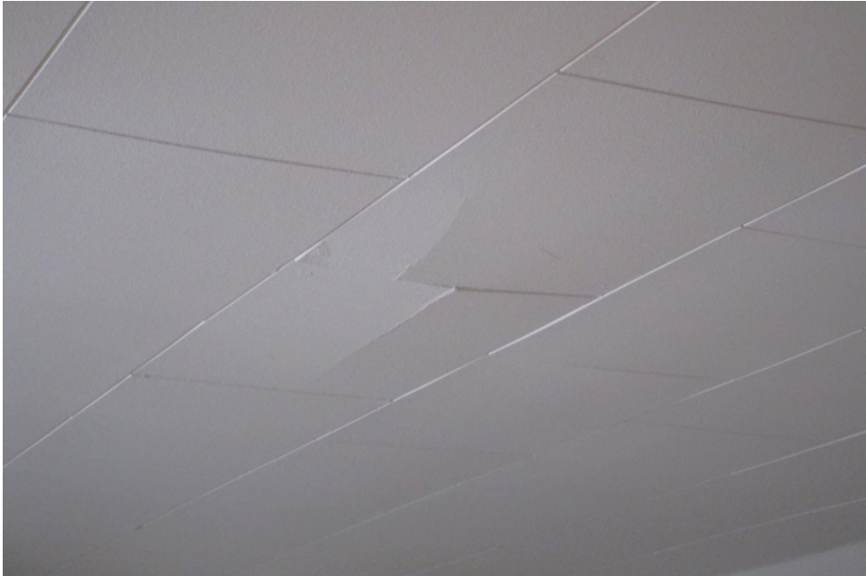
Skade i loft på reposen
