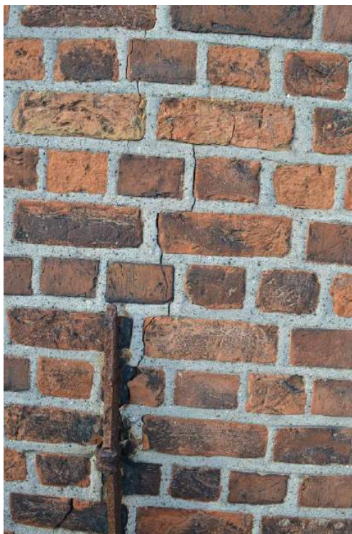
Fig 15: Eksempel på revner ved ankre
