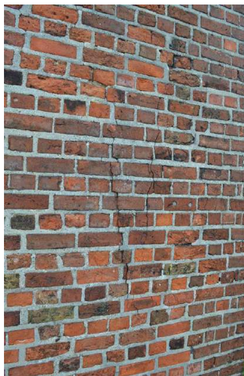
Fig 16: Skade murværk mod vest
