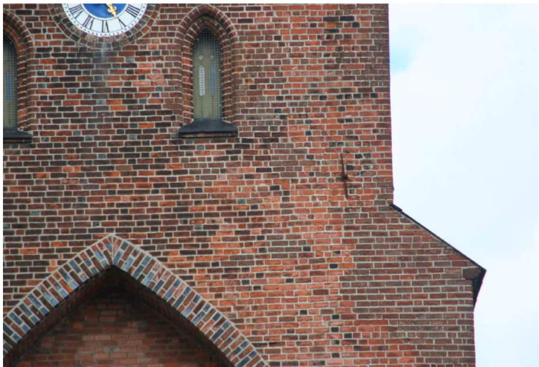
Fig 20: Eksempel på større facadeparti med forvitrede teglsten ved spidsbuen tv. og opad
