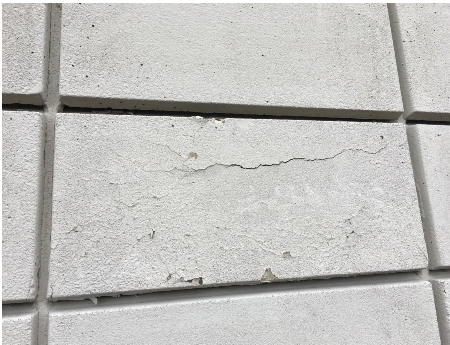
Foto 14. Blok på gavl mod vest, som fremstår med revner og krakeleringer og små afskalninger af overfladen.
