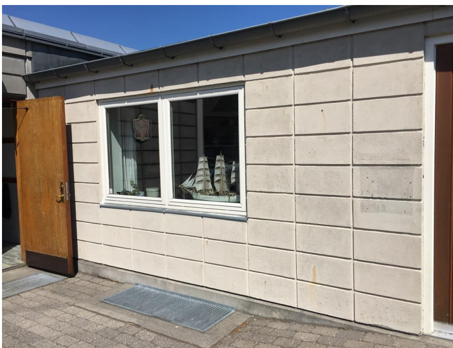
Foto 9. Flere rustpletter på facadeelement mellem tilbygning og oprindeligt byggeri. Forpladen er her uarmeret.
