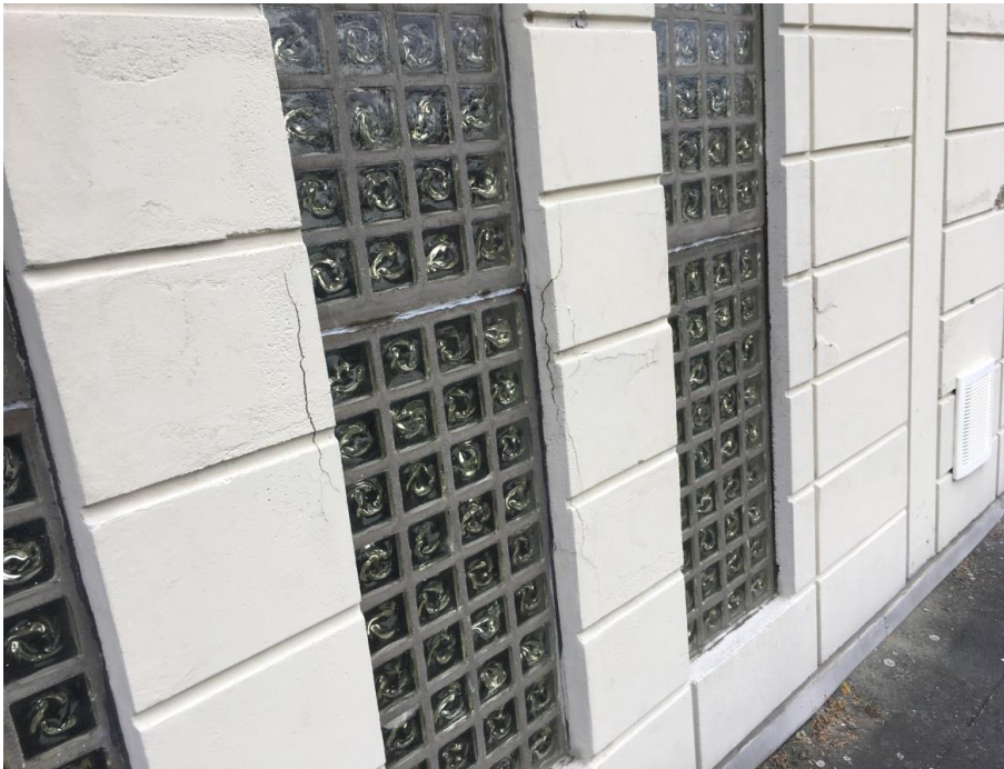
Foto 4. Facadelement på den øvre del. Der ses flere steder revner, som er begyndende afskalninger og korroderende armering.
