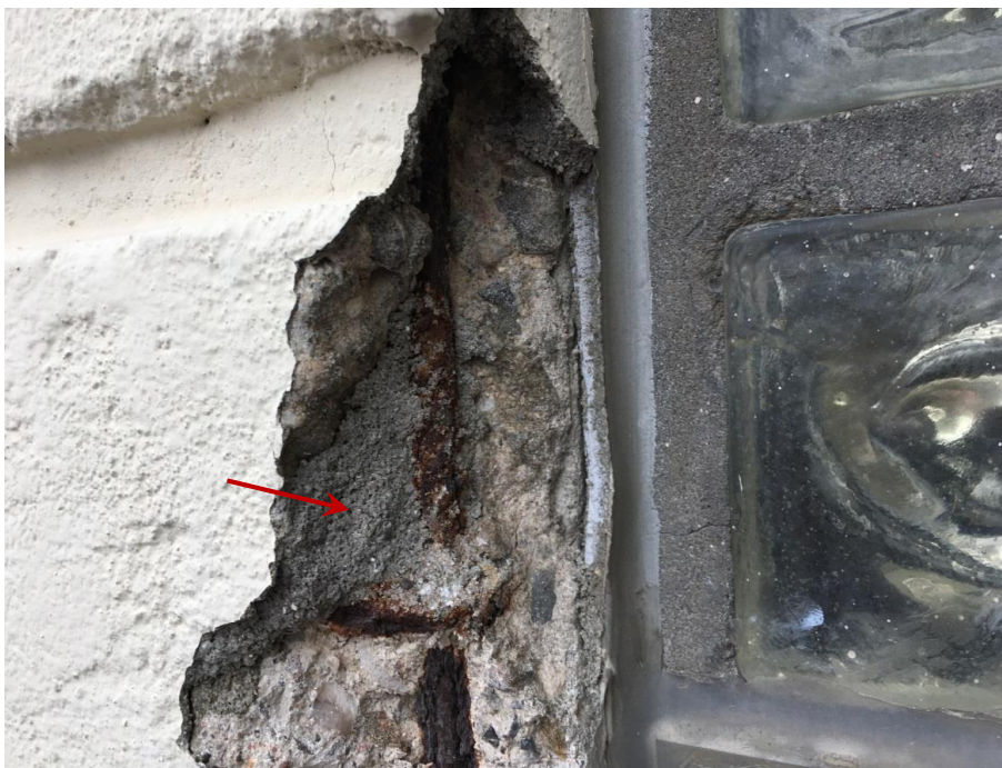
Foto 6. Ved afskalningerne ses rester af reparationsprodukter (pil), hvilket tyder på, at området tidligere er repareret.
