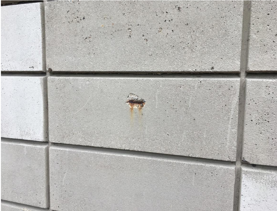
Foto 10. Typisk skade på tårn. Der ses en afskalning over et rustent yderligt liggende jern.
