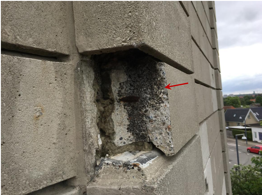
Foto 12. Nedfaldet stykke af en hjørneblok. I brudstedet ses et rustent armeringsjern. Det ses endvidere, at betonen i den yderste plade lokalt er meget tynd(pil).
