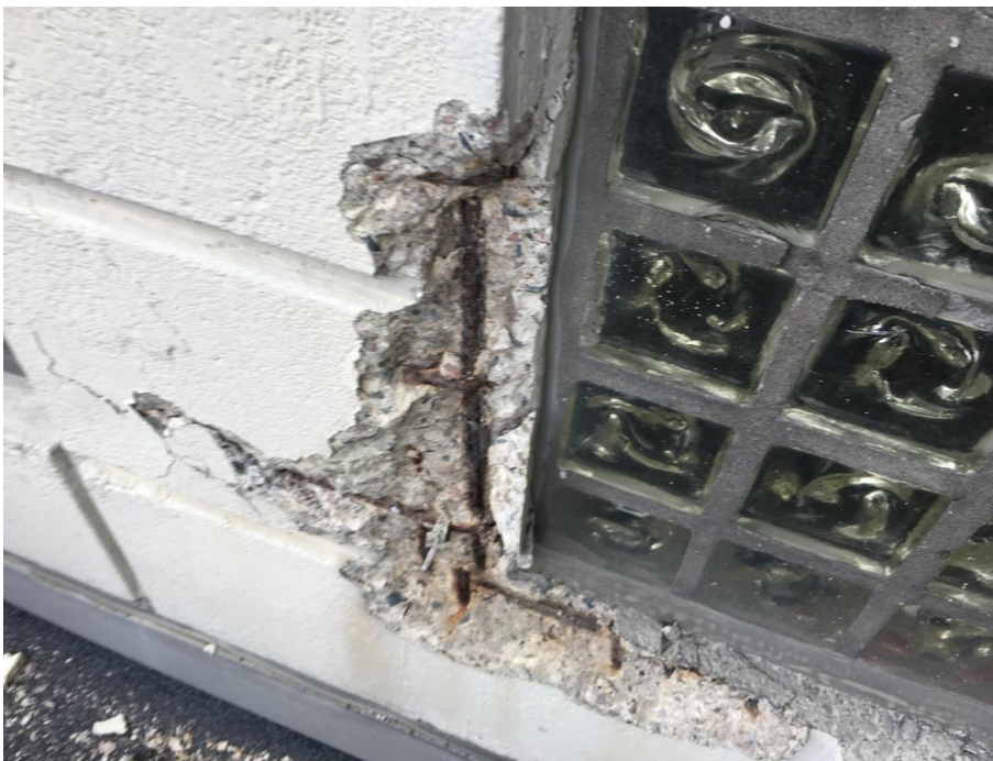
Foto 5. Ved afslåning af de begyndende afskalninger ses korroderende armering bag revnerne.
