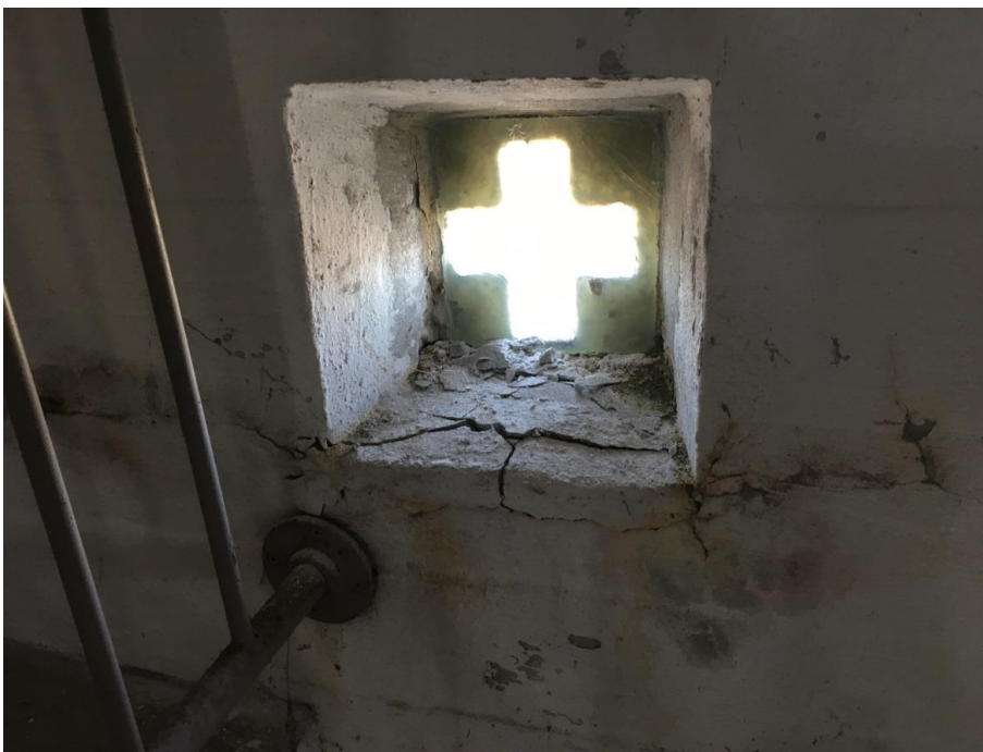
Foto 17. Omkring vindueshuller ses revner og afskalninger som følge af korroderende armering.
