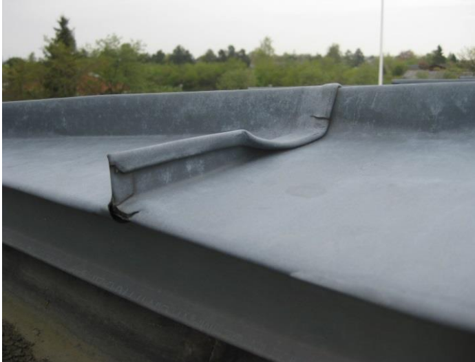
Foto 6 – revner i zinkdækning samt lodrette falssamlinger udført fra forkert side ved grat.
