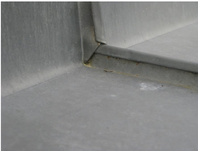
Foto 7 – falssamlingerne, hvor zinken på tagfladerne er bukket op ad de tilstødende vægge er udført forkert.
