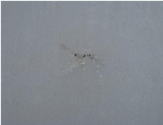
Foto 3 – større huller i zinkdækningen.
