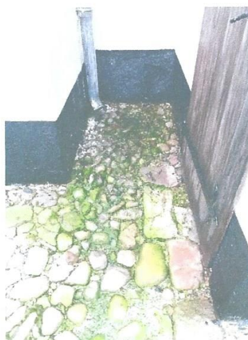
Tagnedløb ført til terræn
