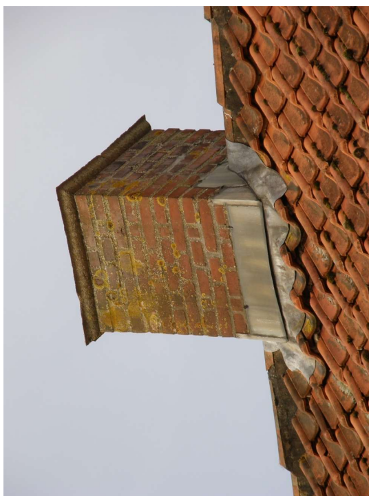
På haveseiden ses udskridningen på især tagstensrækken under rygningen og omkring skorstenen. Her er tagstenene sunket i forhold til den "faste" rygning og skorstenene.
