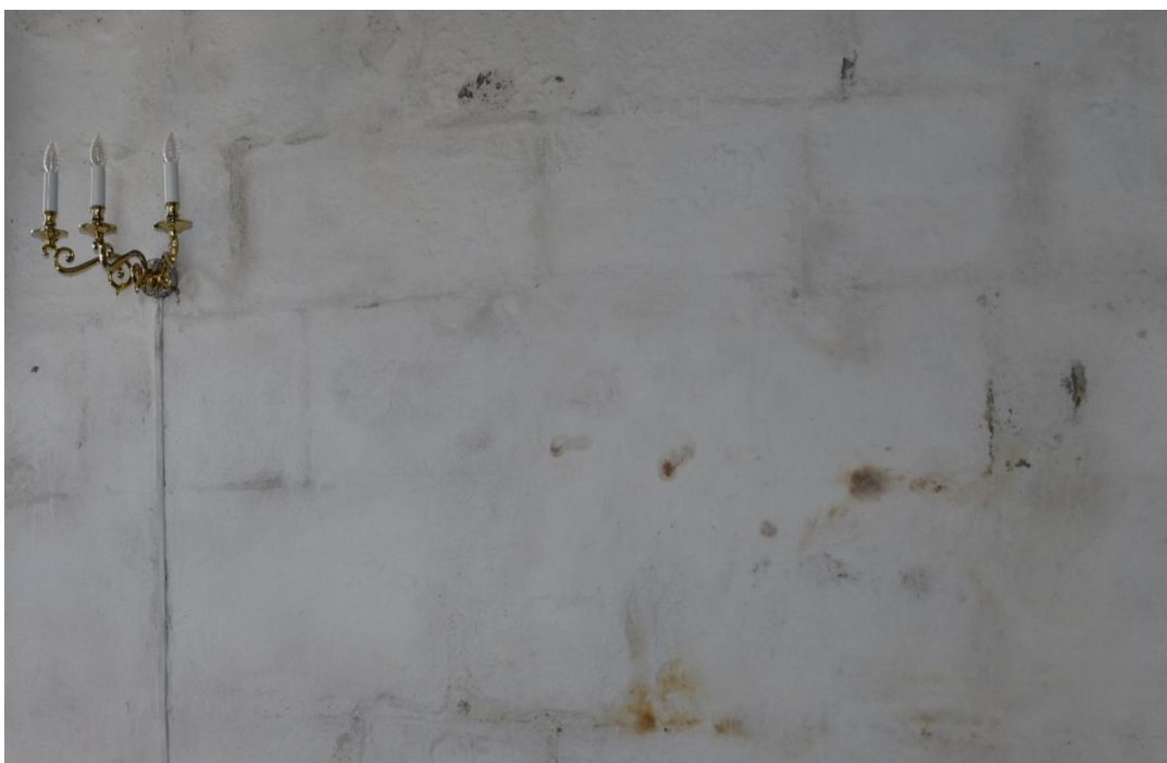
Misfarvninger på murværk i kor
