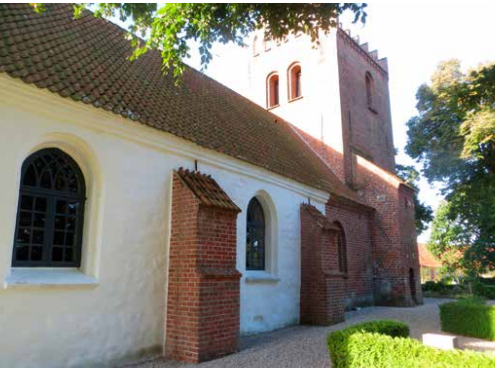
Støttestøtter i Osted kirkes nordside
