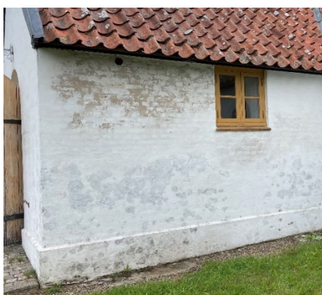
Figur 4. Våbenhus, med afskalning, og opfugtning.
