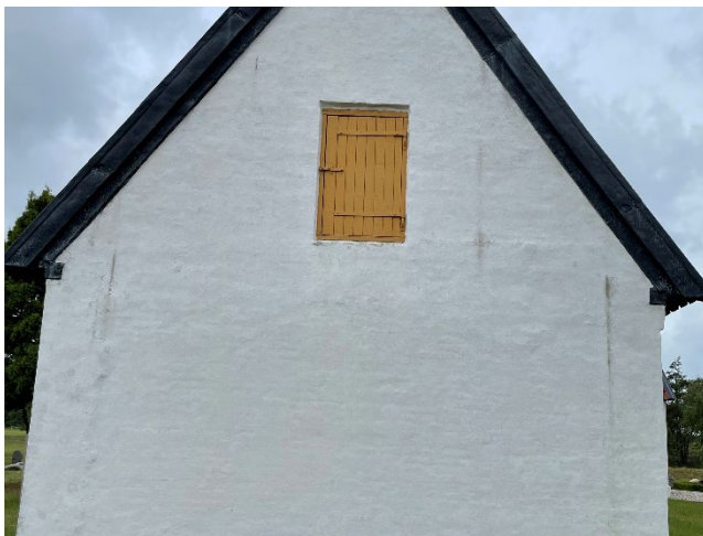
Figur 8. Østgavl med afslidning fra nedsivende regnvand.
