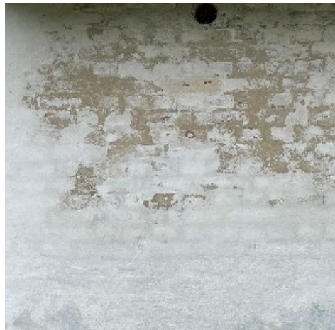
Figur 7. Afskalning over hydraulisk kalkmørtel.
