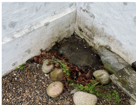
Figur 5. Opfugtet hjørne mellem skib og våbenhus.
