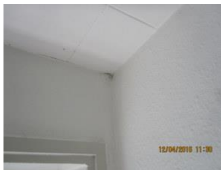
Foto 4. Misfarvninger på ydervæg mod loft
